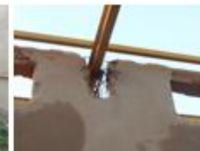
Absence de platine d'encrage
