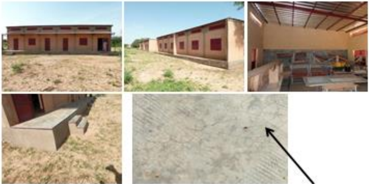
Faïençage de la chape
