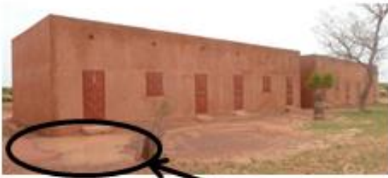
Façade principale : stagnation d'eau de pluie
