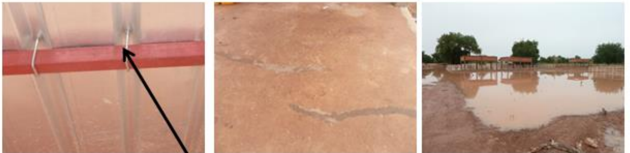
Pas de feutre bitumé sur le tube carré. Dalle au sol non bouchardée
