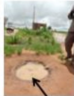
Réseau : fuite d'eau
