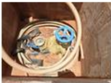
Fuite au niveau de regard
