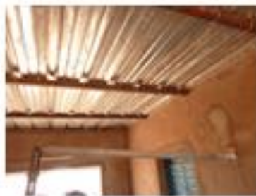
Toiture non étanche
