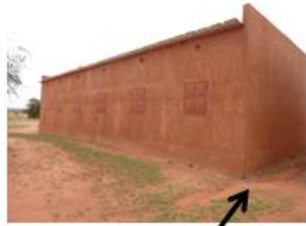
Façade arrière : écoulement des eaux
