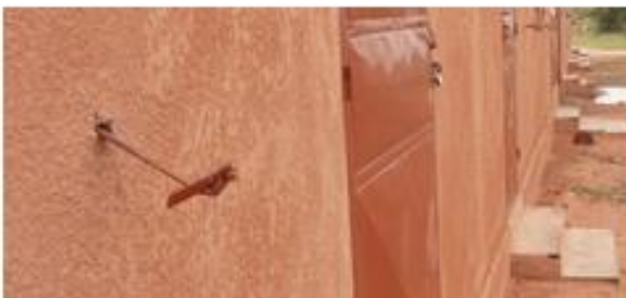
Arrêtoir mal scellé
