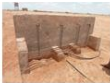
Robinets de la rampe enlevés
