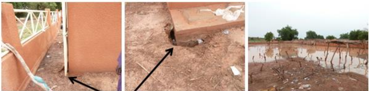
Affouillement due à l'érosion hydrique dans la cour
